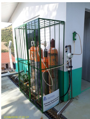
Foto 25 - A desinfecção é realizada com a dosagem de cloro gasoso.
