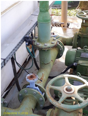
Foto 13 - Válvulas manuais da ETA: dificultam a operação do sistema.
