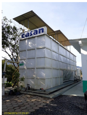
Foto 17 - ETA modular compacta aberta.
