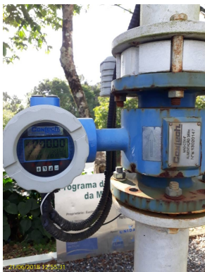
Foto 34 - O medidor de vazão não está funcionando.
