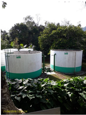
Foto 50 - Dutos de ventilação na cobertura das unidades de concreto armado.
