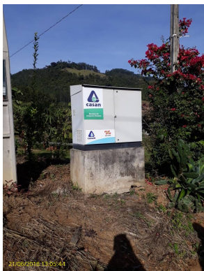
Foto 54 - Booster 02 devidamente identificado.
