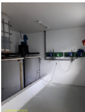
Foto 36 - Bombas dosadoras dos produtos químicos.
