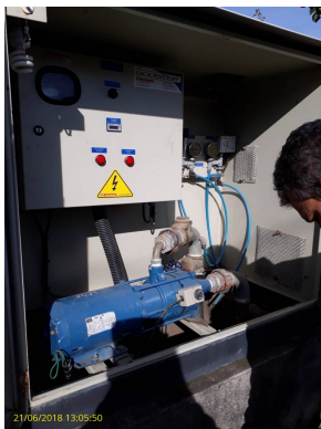
Foto 55 - Instalações da bomba.
