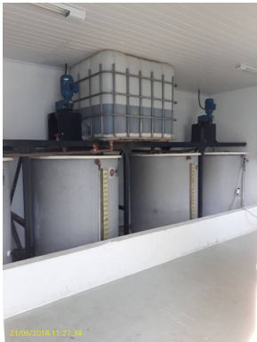
Foto 12 - Tinas de PAC, alcalinizante (quando necessário) e hipoclorito (caso haja problema na dosagem de cloro-gás).
