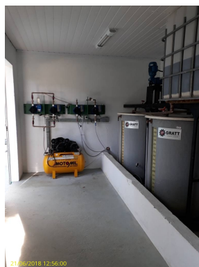
Foto 37 - Bombas dosadoras dos produtos químicos.
