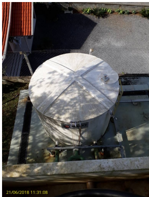
Foto 23 - Tanque de contato.
