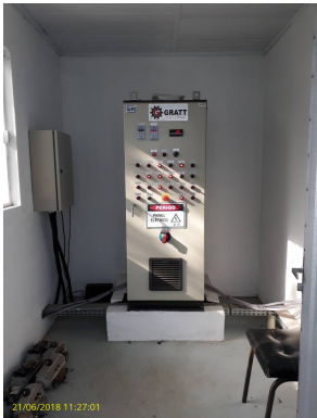
Foto 11 - Painel elétrico de controle da ETA.
