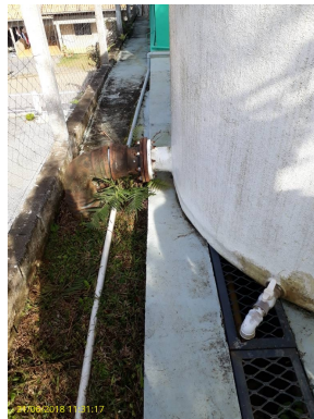
Foto 24 - Saída de água tratada do tanque de contato.
