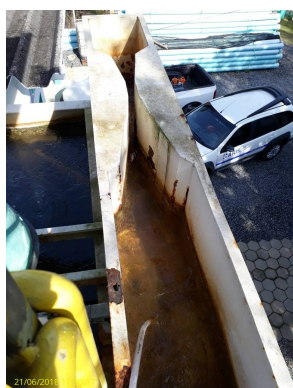
Foto 19 - Calha Parshall: entrada de água bruta.
