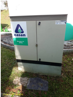
Foto 57 - Booster 03 devidamente identificado.
