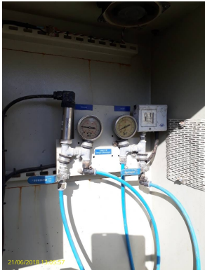
Foto 56 - Medidores de pressão de sucção e de recalque.
